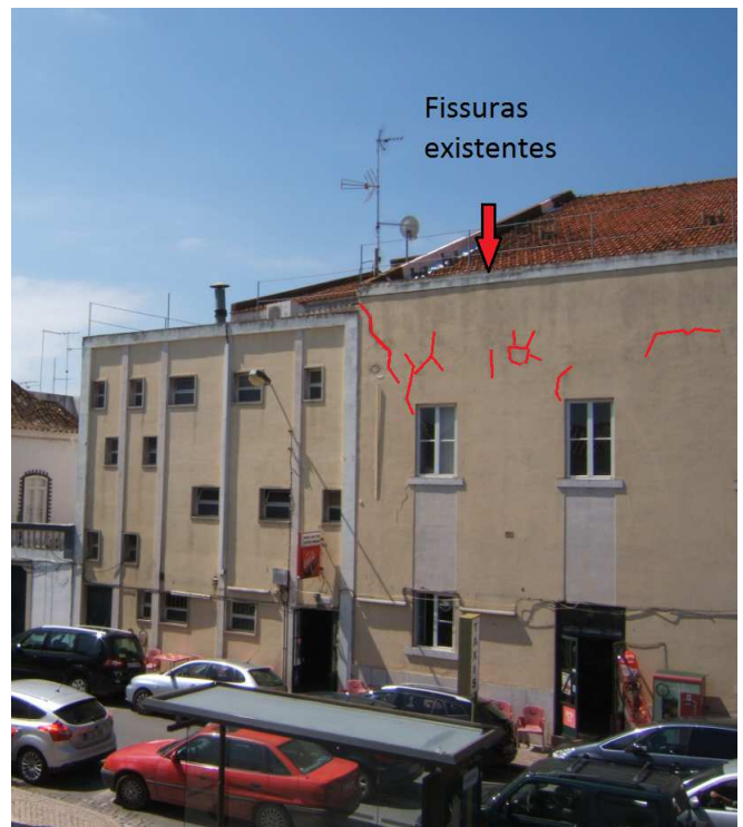
Figura 24 – Fissuras na parede de alvenaria
