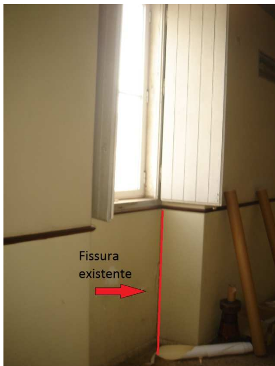
Figura 23 – Fissura em pano de alvenaria na transição de espessura
