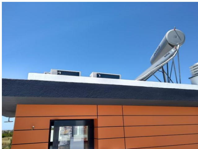
Figura 38 - Sistema Solar Térmico de Termossifão para águas quentes sanitárias
