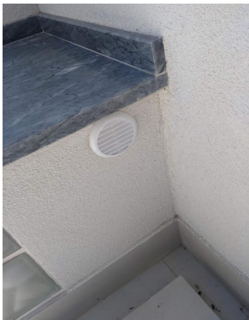
Figura 30 - Conduto de admissão de ar para a cave
