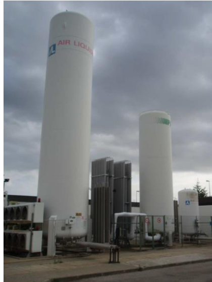
Figura 4.3 – Reservatórios de Oxigénio, Azoto e Dióxido de Carbono da ETA de Tavira [Maié, D. (2008)]
