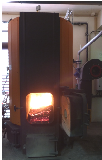
Foto 7 - Caldeira a biomassa (03-04-2014)
