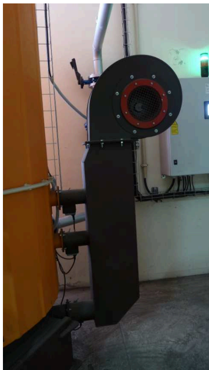
Foto 9 - Sistema de insuflação de ar (03-04-2014)
