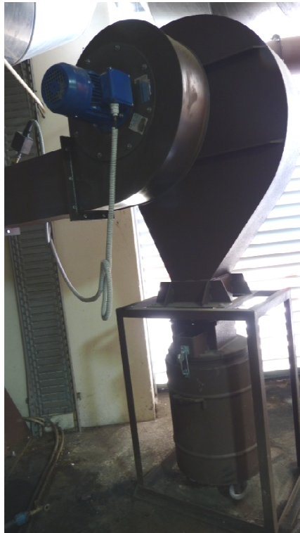
Foto 8 - Depurador de cinzas e ventilador de tiragem forçada (a azul na foto) (03-04-2014)
