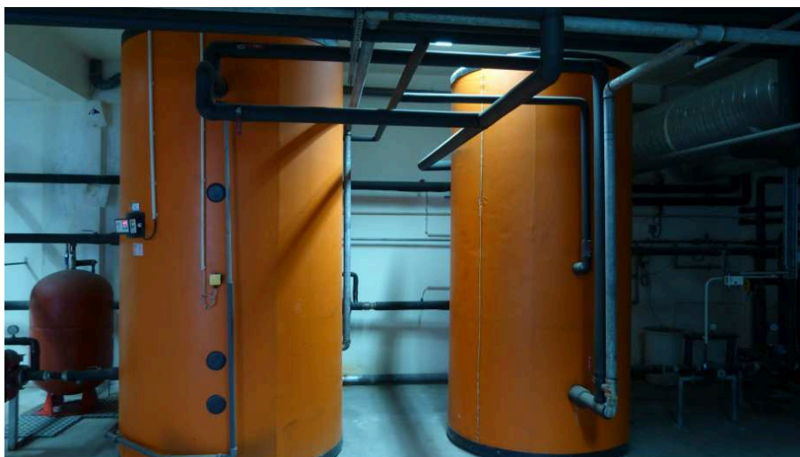
Foto 5 - Depósito do solar e da caldeira para aquecimento de águas para banhos (25-11-2013)
