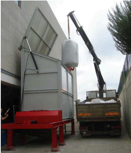
Foto 18 - Abastecimento do silo da caldeira (23-09-2013)
