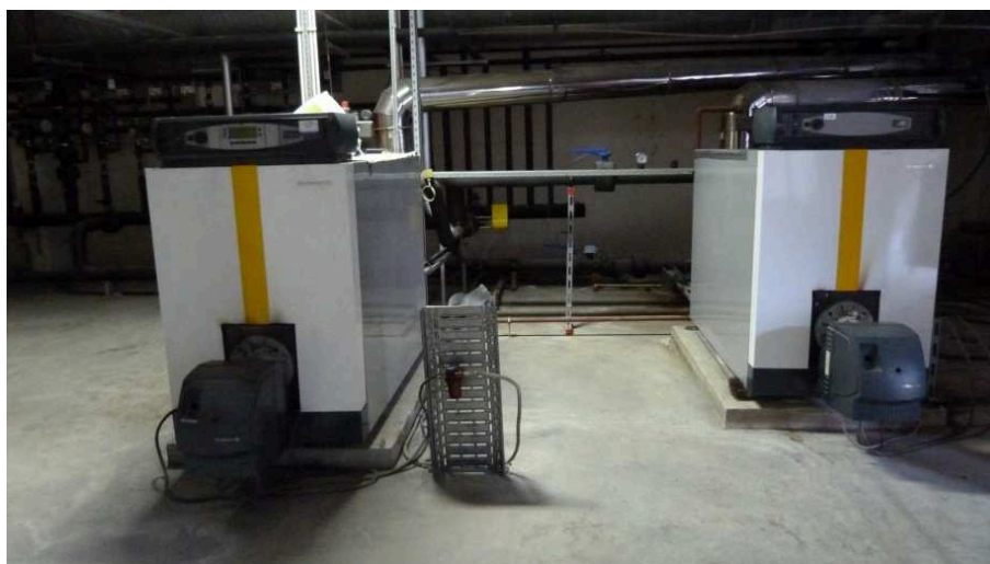
Foto 4 - Caldeiras a gasóleo existentes (25-11-2013)
