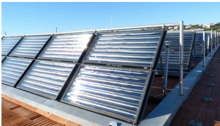
Foto 3 - Coletores solares CPC Ao Sol (25-11-2013)
