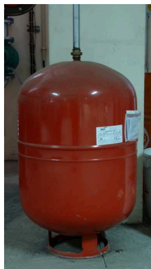
Foto 15 - Vaso de expansão de água (03-04-2014)
