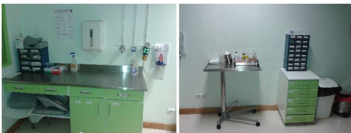
Figura 5 – Armários com material de apoio e rampas de oxigênio e de vácuo.
