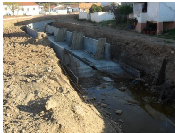
FIG 2.4 O uso das técnicas de engenharia civil na Ribeira de Perna Seca, Sobral da Adiça
