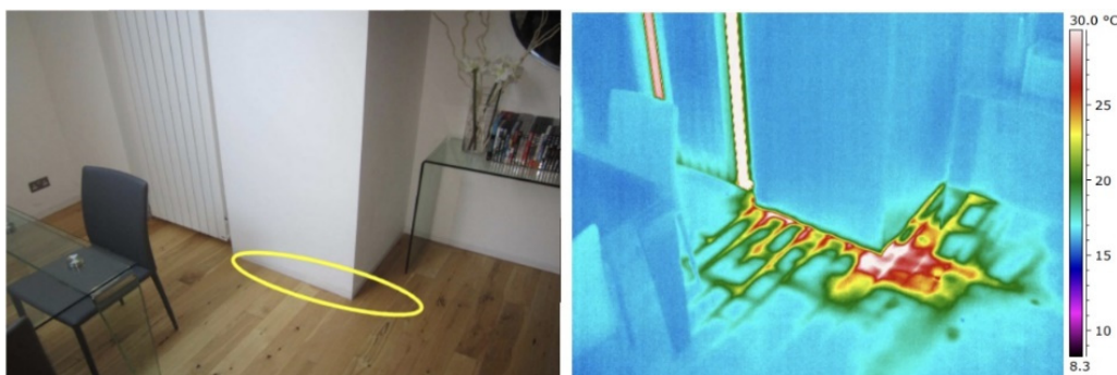
Figura 4 – Detecção de uma fuga de água (Pixel Thermographics, s.d.).
