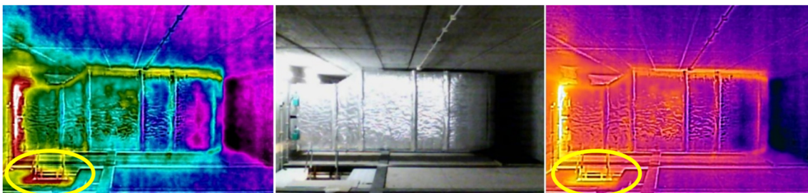
Figura 140 - Imagem termográfica filtro Rainbow HC, fotografia digital e filtro Iron.
