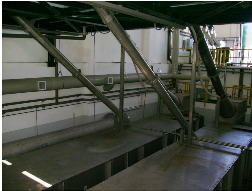
Figura 20 - Tratamento preliminar em equipamento compacto (tamisador + desarenador/desengordurador).
