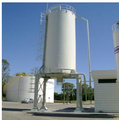
Figura 41 - Silo de armazenamento lamas desidratadas.
