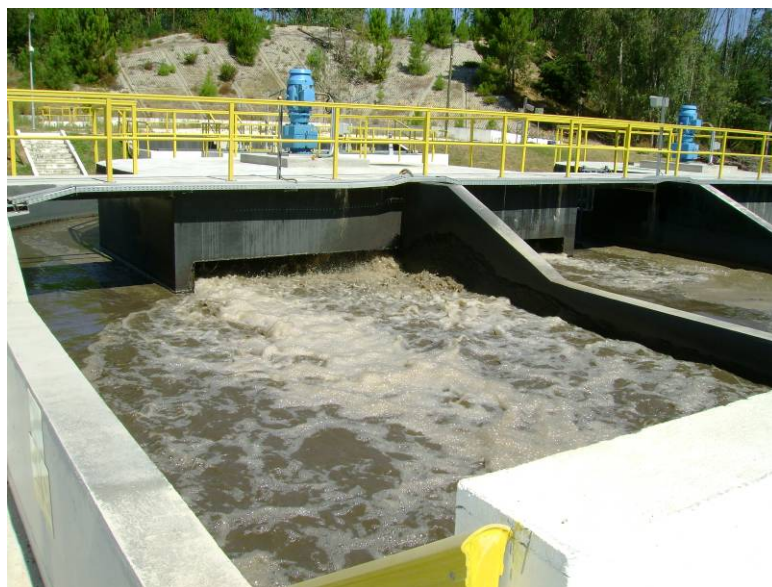
Figura 26 - Local de afluência do reactor biológico.
