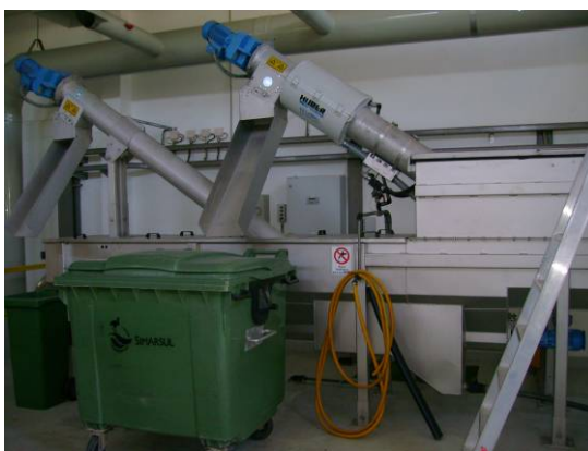
Figura 22 -Unidade compacta de tratamento de lamas de fossas sépticas.
