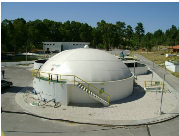
Figura 37 - Novo digestor anaeróbio.
