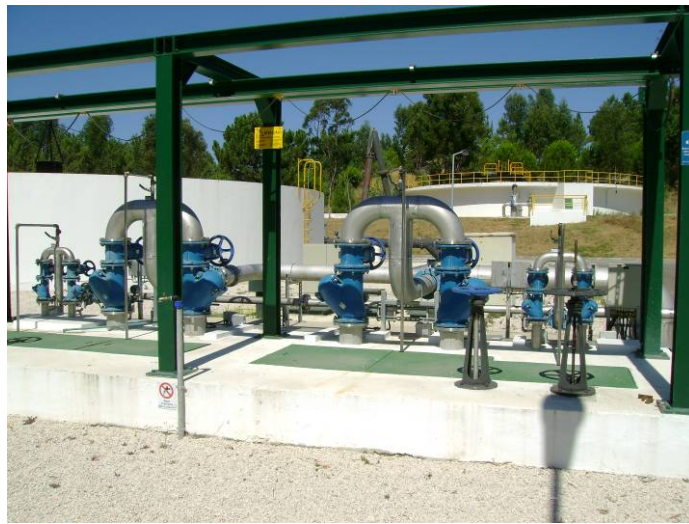
Figura 31 - Estação elevatória de recirculação de lamas.
