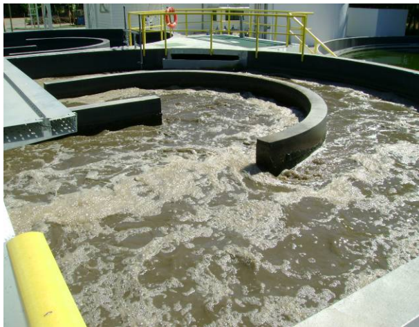
Figura 27 - Zona aeróbia do reactor biológico.
