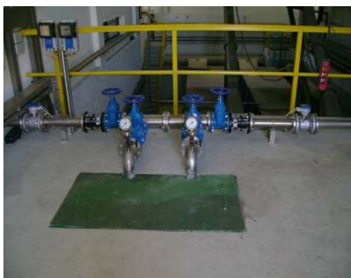
Figura 21 – Electrobombas da UC.
