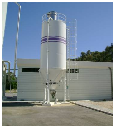
Figura 42 - Silo armazenamento CaO.
