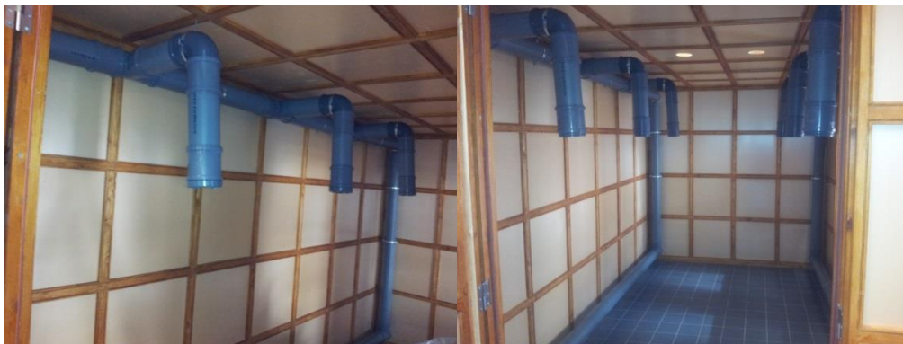
Figura 5 - Montagem do sistema de ventilação no interior da câmara experimental "Sala Piloto".
