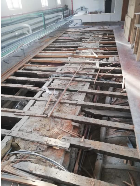
Figura 61 - Sótão do Edifício Diogo de Sousa, onde se pode ver vestígios por baixo do soalho de madeira da primitiva construção
