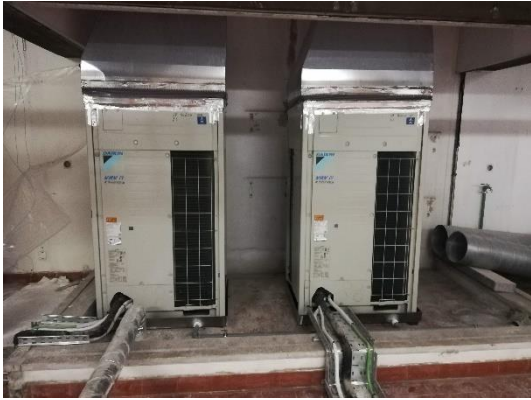
Figura 84 - Motores dos Ar Condicionado
