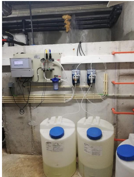
Figura 64 - Doseadores de Cloro das Piscinas
