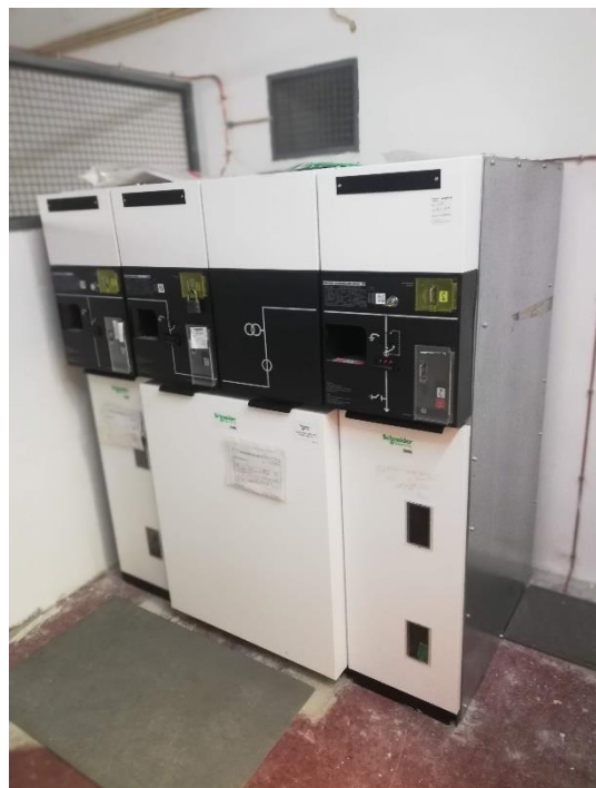
Figura 83 - Posto de transformação
