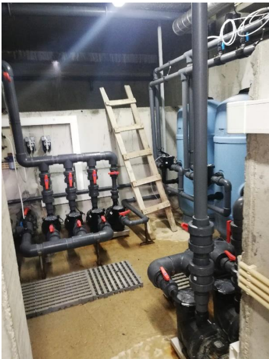
Figura 62 - Bombas das Piscinas Exteriores
