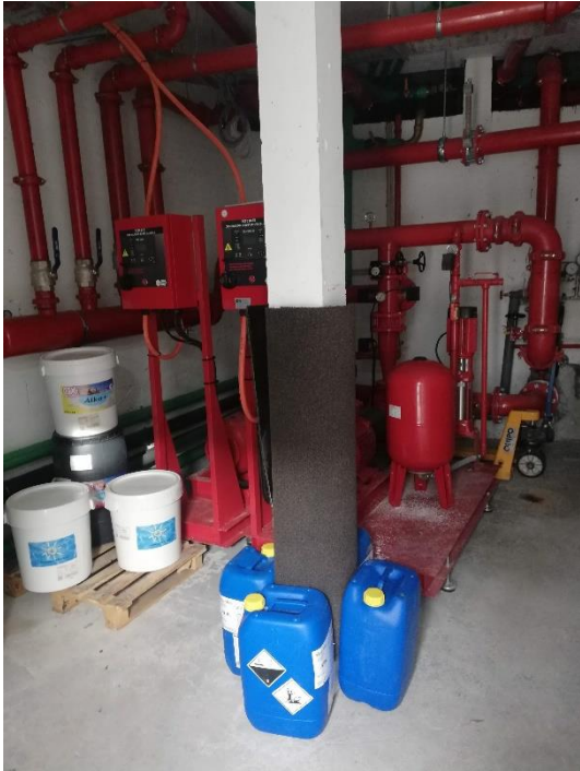
Figura 65 - Central de Bombagem
