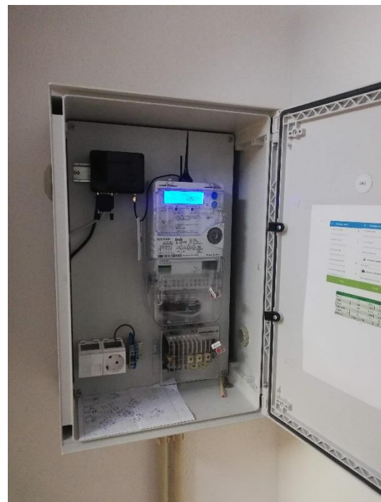
Figura 88 - Contador de Eletricidade
