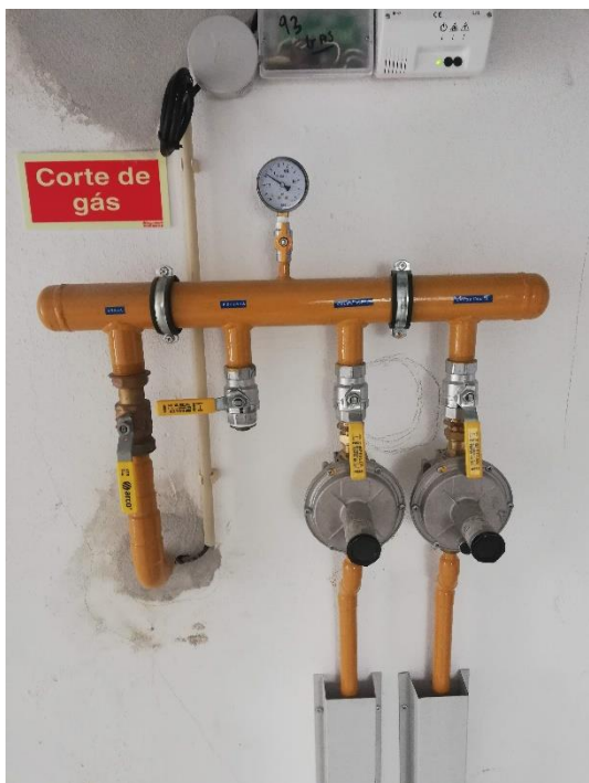
Figura 56 - Válvulas de segurança (Gás)
