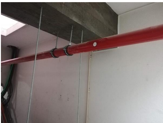
Figura 80 - Conduta de água quente com ponto de picagem do Infraspick durante a ronda diária
