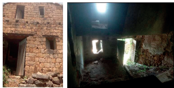
Fig. 2 Relevé d'une maison traditionnelle à sa première extension, vues de l'extérieur et de l'intérieur (Zoulikha Ait-Lhadj, enquête terrain 2017/2018)
