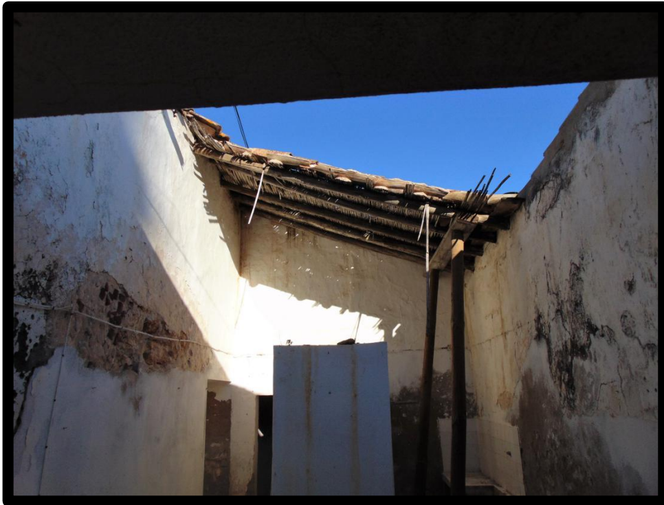
▲ O telhado da casa do eremita já desabado (em 2019)
