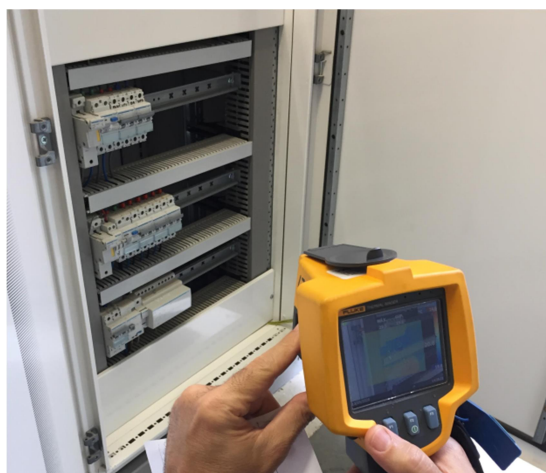
Figura 45 – Inspeção termográfica do Q.G.B.T. do PT.
