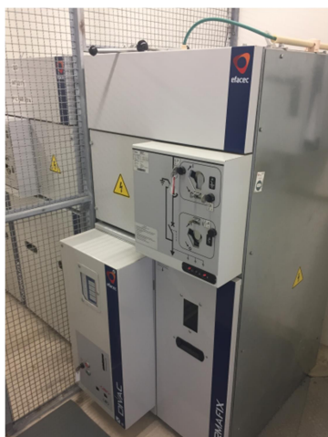
Figura 41 – Cella de proteção por Disjuntor.
