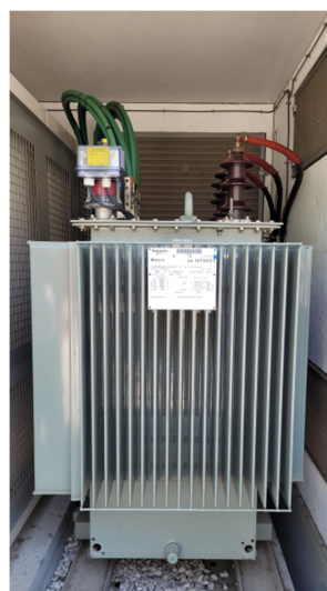
Figura 44 – Transformador a Óleo de 1000 kVA – Escola Francisco Fernandes Lopes.
