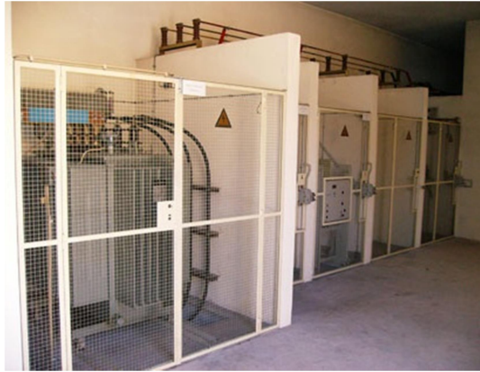
Figura 10 – Posto transformação com barramentos isolado a ar [11].
