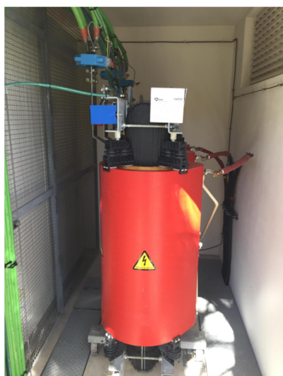
Figura 43 – Transformador seco de 630 kVA – Escola João de Deus.
