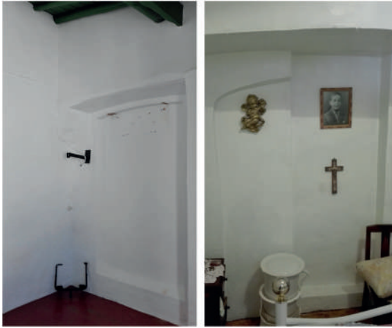
Fig. 6 Vãos em paredes meãs, agora fechados
