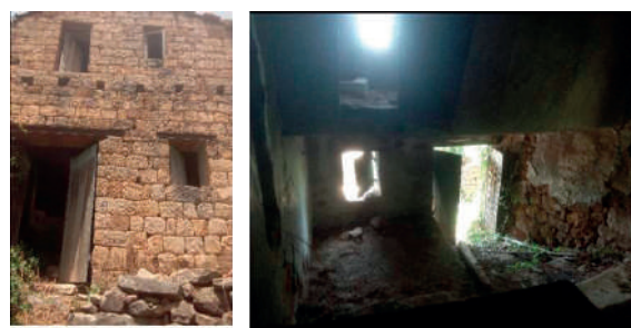
Fig. 2 Relevé d'une maison traditionnelle à sa première extension, vues de l'extérieur et de l'intérieur (Zoulikha Ait-Lhadj, enquête terrain 2017/2018)
