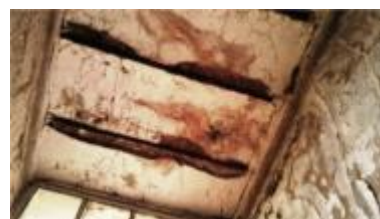
Figura 14 - Corrosão em vigas.
