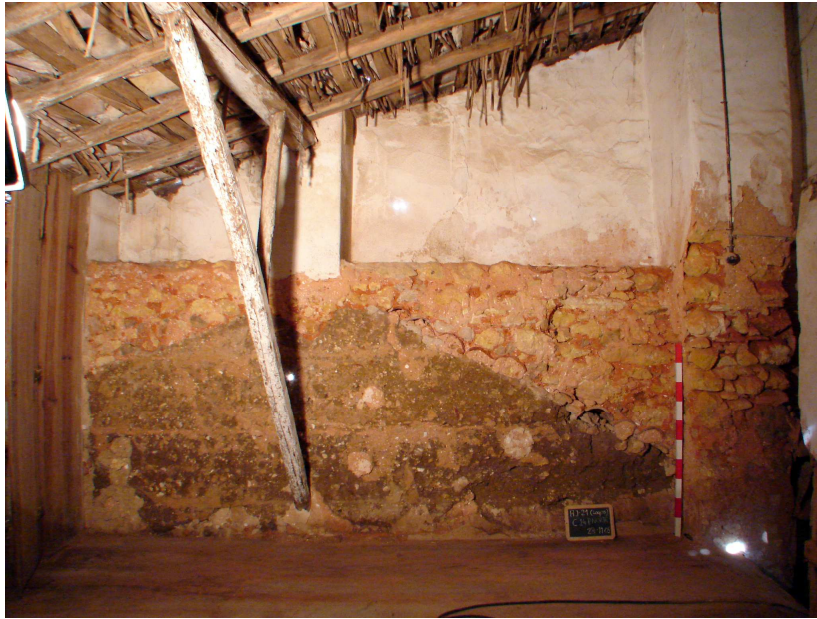
Figura 8 – Rua do Jardim, nº 21, Lagos. Sondagens diagnóstico efectuadas no interior dos edifícios. Compartimento 14, onde se notam os vestígios de um anterior telhado (Fonte: Autora).
