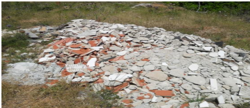
Figura 5.13-Resíduos de alvenaria e aglomerados de betão.
