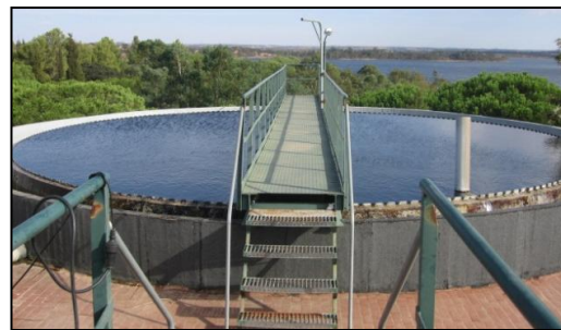
Figura 11- Decantação realizada na ETA de Castro Verde
