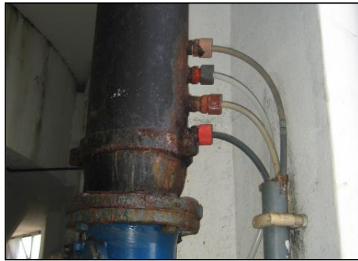
Figura 10 – Ponto de injeção dos reagentes na ETA de Castro Verde
