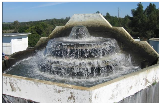
Figura 9 -Arejamento efectuado na ETA de Castro Verde
