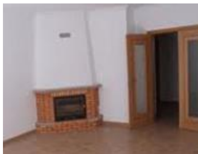
Figura 4 - Recuperador de calor instalado numa lareira.
