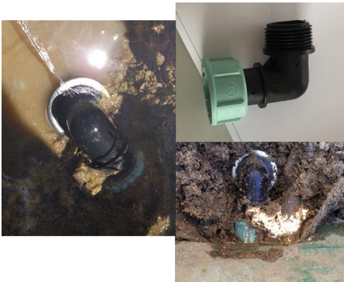
Figura 30 – Identificação da rotura, Peça de substituição e conclusão da tarefa
