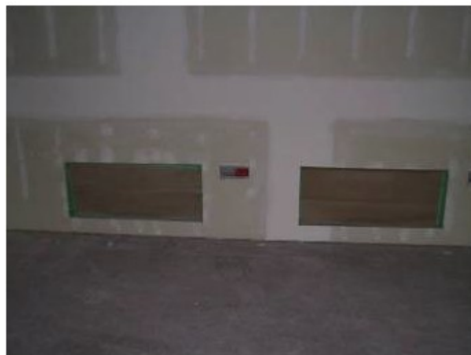
Foto 11 – Protecção do sistema ventilação.
