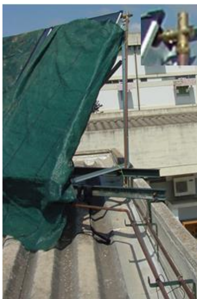
Figura 21 – Colocação do sensor de temperatura de saída dos coletores.
