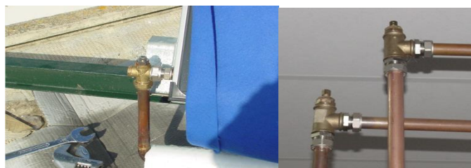
Figura 20 - Sensor de temperatura e purgadores de ar do circuito primário dos coletores solares térmicos.
