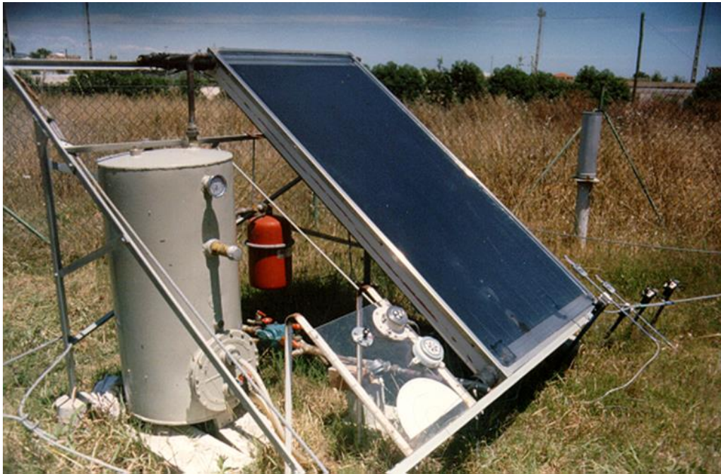
Foto da instalação experimental para a determinação da reta do rendimento de um painel solar térmico.
