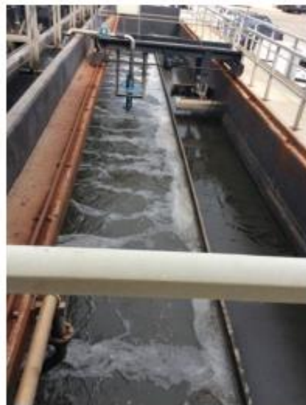
Figura 2.7 - Ponte raspadora de superfície da ETAR de Albufeira Poente (Fonte: AREAL, 2020)
