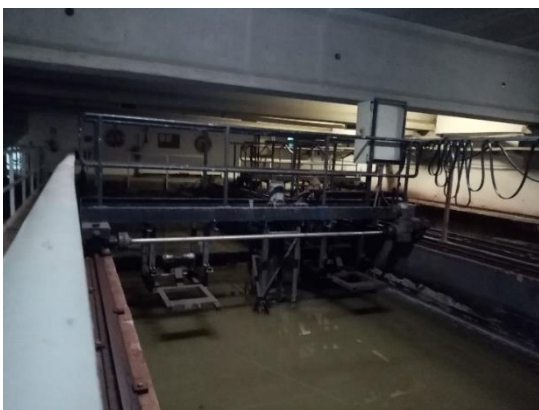
Figura 3.13 – Canal Desarenamento/Desengorduramento da ETAR de Vale Faro (Fonte: Autor, 2021)
