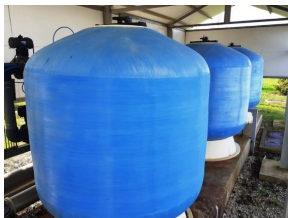
Figura 3.7 - Filtros de Areia da ETAR de Albufeira Poente (Fonte: Autor, 2021)
