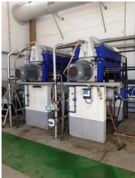
Figura 3.8 - Centrífugas para desidratação de lamas da ETAR de Albufeira Poente (Fonte: Autor, 2021).
