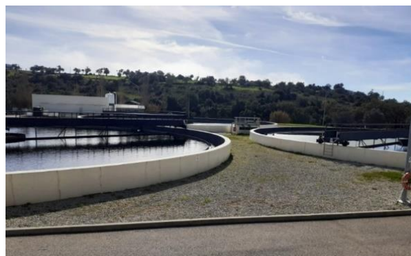
Figura 3.5: Decantadores Secundários ETAR de Albufeira Poente (Fonte: Autor, 2021)
