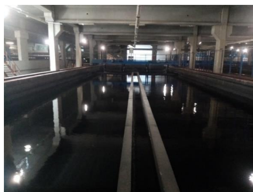
Figura 3.16- Valas de Oxidação da ETAR de Vale Faro (Fonte: Autor, 2021)
