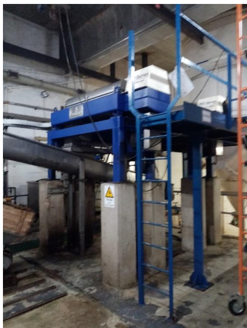
Figura 3.18 - Dedsidratação por centrifugação da ETAR de Vale Faro (Fonte: Autor, 2021)
