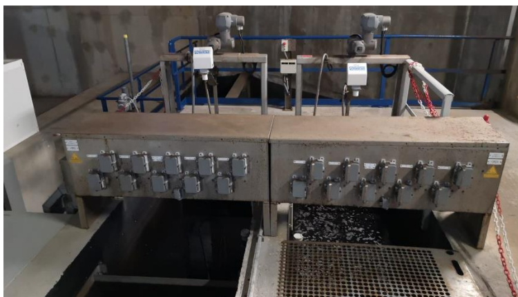
Figura 3.17 - Processo de desinfecção da ETAR de Vale Faro (Fonte: Autor, 2021)
