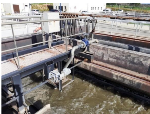
Figura 3.2 – Canal Desarenamento/Desengorduramento da ETAR de Albufeira Poente (Fonte: Autor, 2021)
