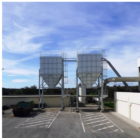
Figura 3.9 - Silos para armazenamento temporário das lamas da ETAR de Albufeira Poente (Fonte: Autor, 2021)
