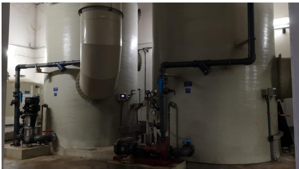
Figura 3.20 - Torres Verticais de Lavagem Química da ETAR de Vale Faro (Fonte: Autor, 2021)
