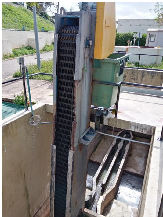
Figura 2.4 - Grade mecânica da ETAR das Ferreiras (Fonte: Autor, 2020)
