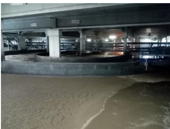
Figura 3.15 - Decantadores da ETAR de Vale Faro (Fonte: Autor, 2021)
