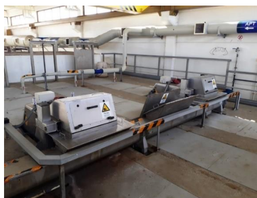
Figura 3.3 - Sistema de Gradagem da ETAR Albufeira Poente (Fonte: Autor, 2021)
