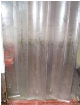
Fig. 2.3: Fitas plásticas existentes na porta de entrada da câmara de frio n.º 1.
