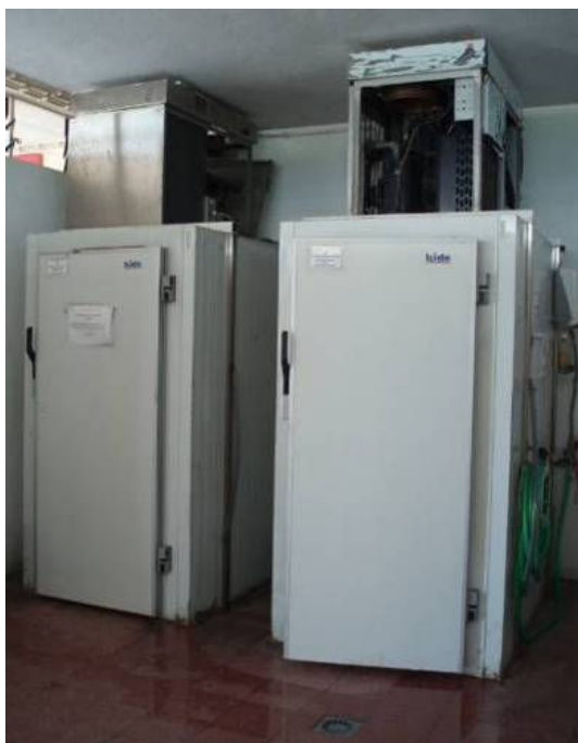
Fig. 2.2: Máquinas de gelo n.º 1 e n.º 2.
