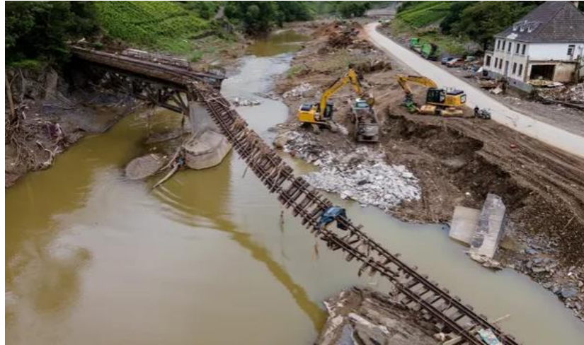
Figura 2.27 – Ponte rodoviária e margens de um rio danificadas após inundações, Alemanha 2021 (Carrington, 2021).
