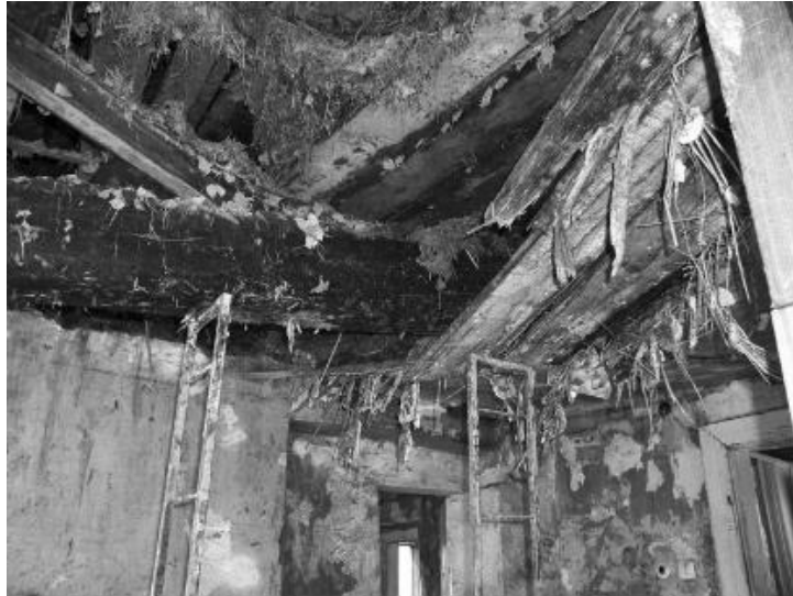
Figura 2.30 - Vigas do piso de madeira deteriorada de uma casa que ficou totalmente imersa na água durante a inundação, Praga 2002 (Drdacky 2010).
