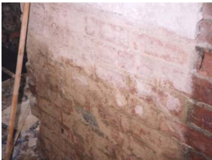
Figura 2.31 - Dano devido a ação química após edifício ser inundado, Keighley 2000 (Kelman & Spence, 2004).
