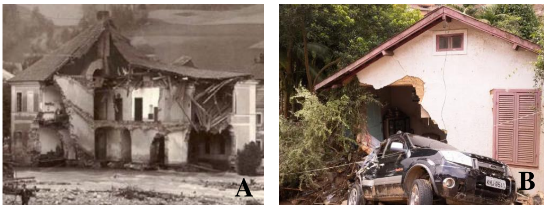
Figura 2.22 – Imagem A - destruição parcial de uma casa devido ao enfraquecimento da fundação numa inundação, Bohemia 1897 (Drdacky, 2010). Imagem B – Casa parcialmente destruída por um veículo que foi arrastado pelas águas de inundação, Petrópolis 2022 (CNN, 2022).
