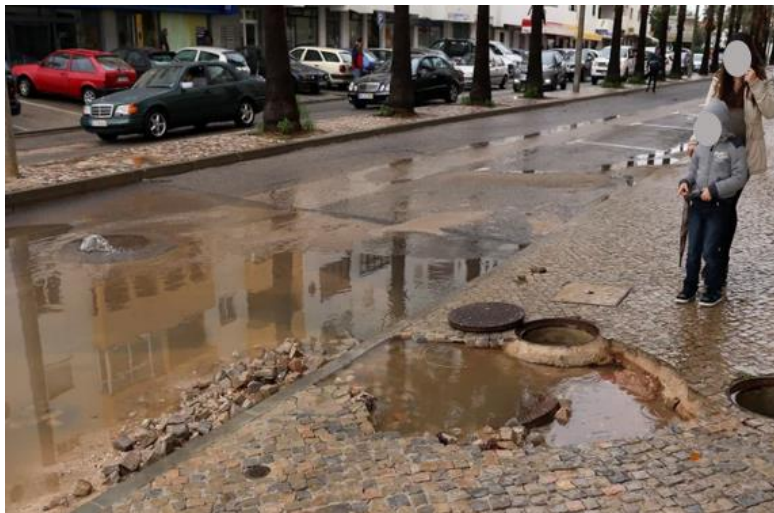
Figura 2.34 - Sistema de drenagem rompido e passeio danificado após uma inundação, Algarve 2020 (Lusa, 2020).
