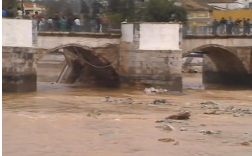
Figura 2.28 – Estrutura de ponte romana afetada por inundações, Tavira 1989 (RTP, 1989).
