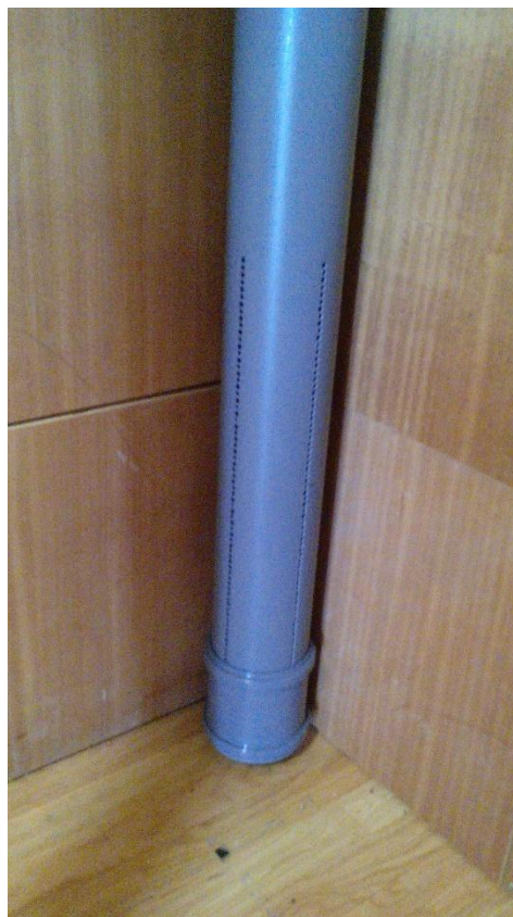
Figura 68: Pormenor da conduta com os orifícios de insuflação.
