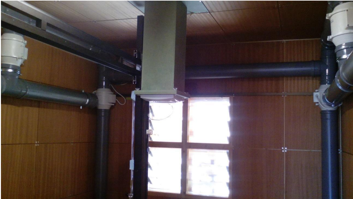
Figura 67: Ventiladores e extrator montados na sala.
