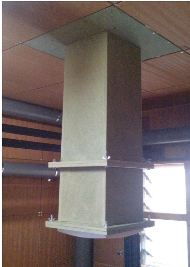
Figura 65: Exaustor de extração do ar da sala.
