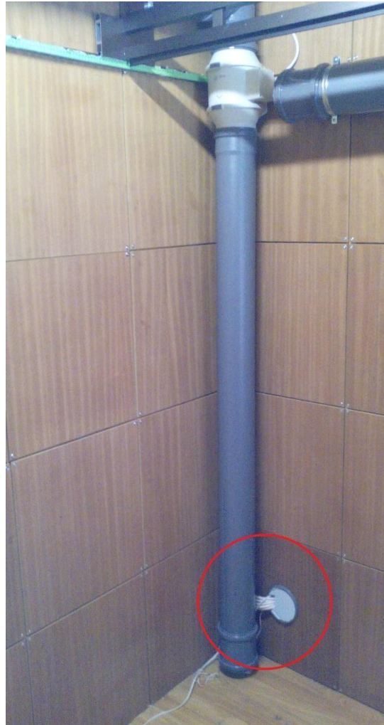
Figura 64: Saída do cabo elétrico para o quadro elétrico.
