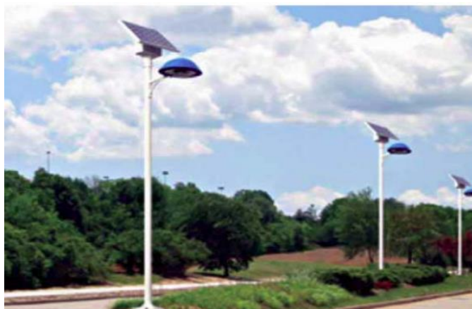
Figura 1.4: Luminárias alimentadas a energia solar fotovoltaica, instaladas em Cabo Verde [12]
