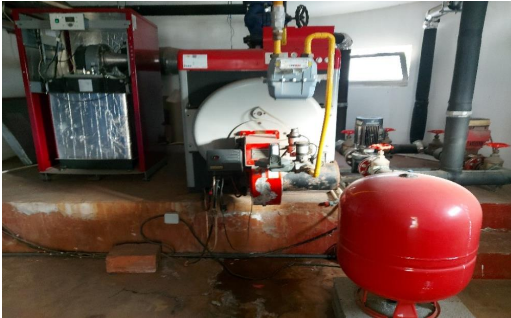
Figura 5.33 - Caldeira de aquecimento
