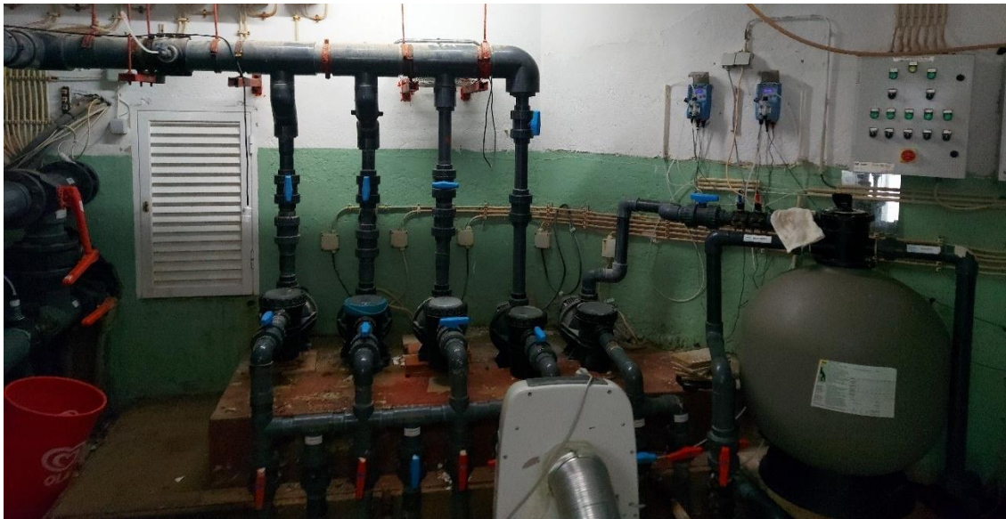
Figura 5.31-Bombas e filtros da piscina
