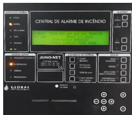
Figura 5.32- Central de incêndios
