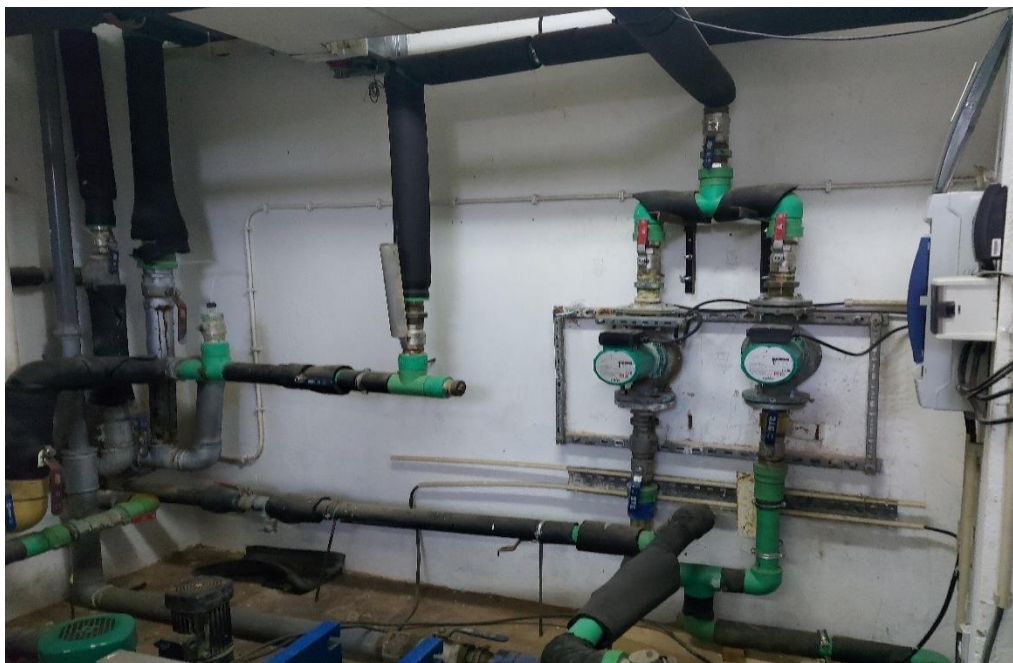
Figura 5.30- Bombas de elevação sanitária
