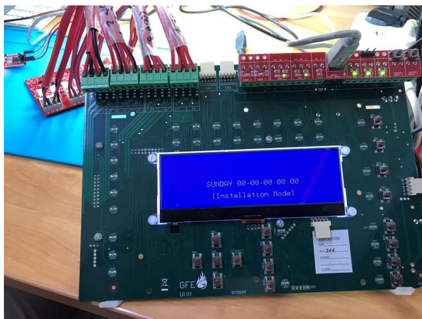
Figura 4-16 – Conexão do Device Emulator ao Painel Gekko.
