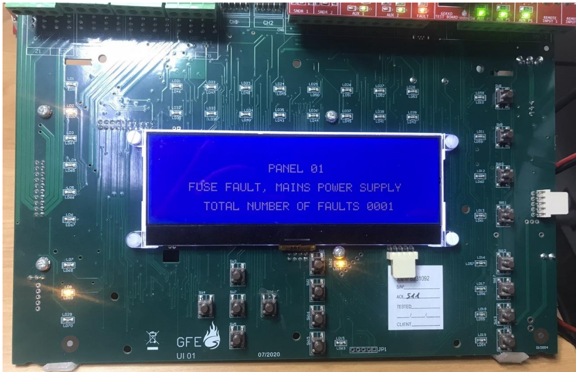
Figura 4-32 - Painel em falta devido a falta de alimentação principal
