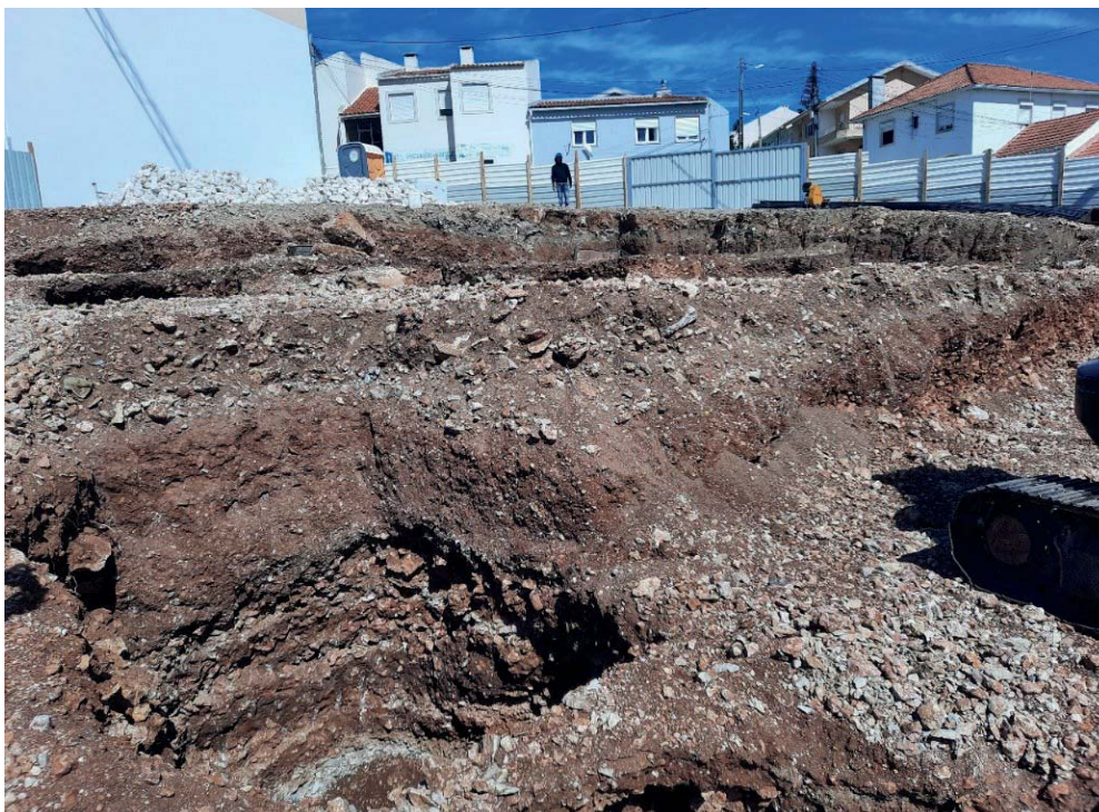
Fig. 2 – Rossio de Porto Salvo. Vista parcial do sector norte do terreno, observando-se algumas das valas abertas para as sapatas das estruturas a construir. Em primeiro plano, escavação com a profundidade máxima de 1,90m, evidenciando as diferentes deposições de aterros para ali despejados em época moderna.
