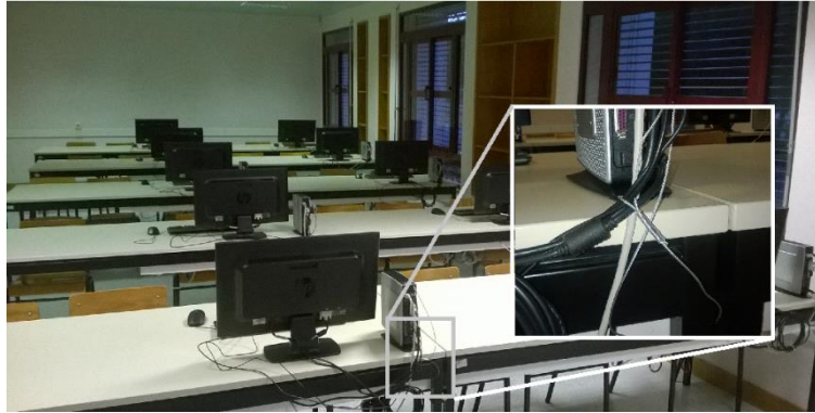
Figura 6.34 - Sala de aula com os terminais instalados.
