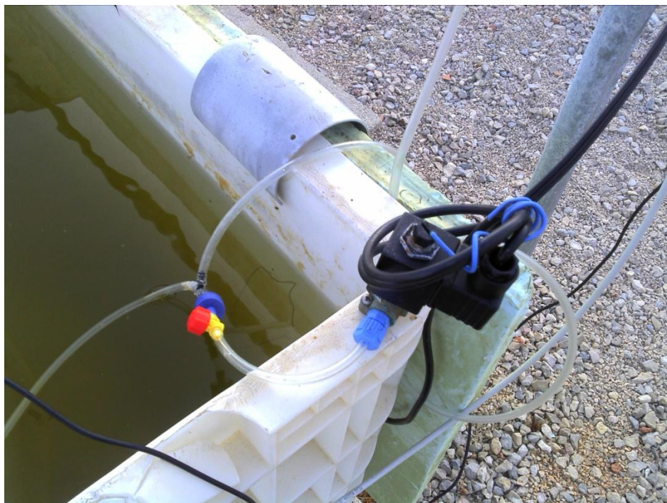
Figura 3.4 - Eletroválvula (visível a válvula manual (vermelha), e bifurcação de entrada de CO 2 / entrada de ar comprimido / saída de mistura)
