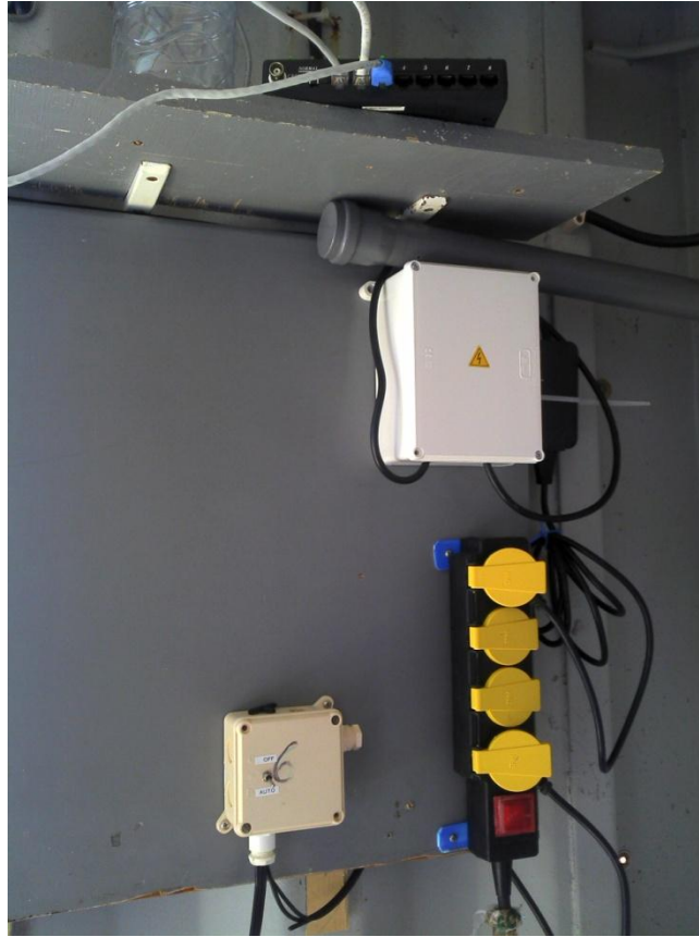
Figura 3.5 - Quadro de alimentação (visível a caixa do transformador, interruptor de corte da eletroválvula, tomada de alimentação e hub de rede)
