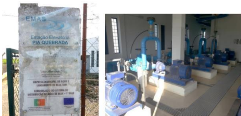
Figura 43. Estação elevatória da Pia Quebrada
