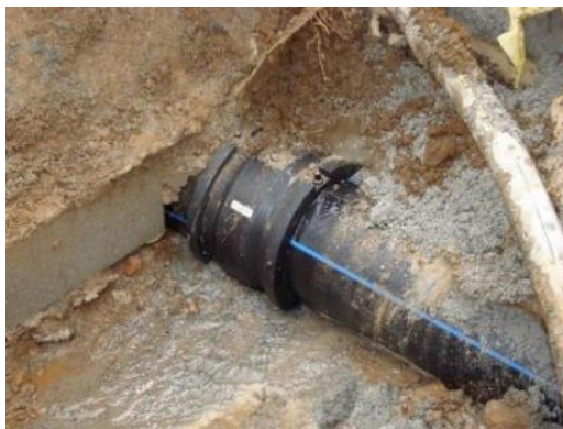
Figura 1. Fuga de água numa conduta
