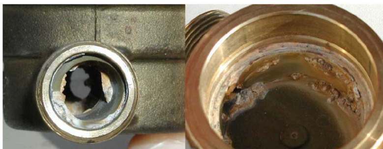
Figura 7. Acumulação de calcário no interior de um contador (Arregui, et al., 2005)
