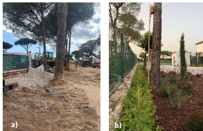
Figura 2.32. Fotografias da evolução da obra do Lote Pinhal Velho 74, Vilamoura. Imagens obtidas por câmara fotográfica a) a 6 de abril de 2022 e b) a 17 de junho de 2022.
